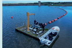
Reparação de fuga e manutenção geral na jangada de captação Albufeira de Monte da Rocha, 17 de fevereiro de 2026
